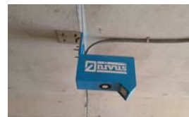
BOX형 사각수로 NivuFlow 7550 적용현장
