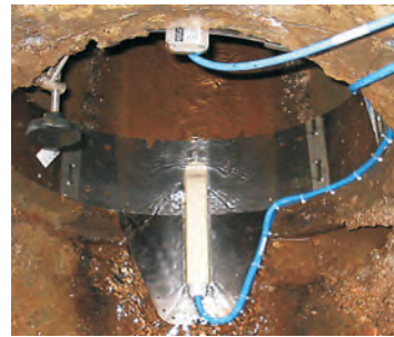
보조 수위계 설치 적용 현장
