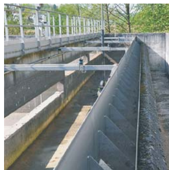
정수처리장 수위 측정 현장
