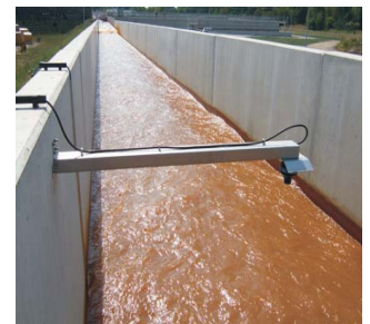
하수처리장 수위 측정 현장
