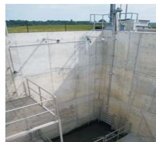
정수처리장 수위 측정 현장
