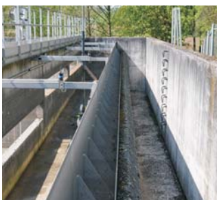
하수처리장 수위 측정 현장
